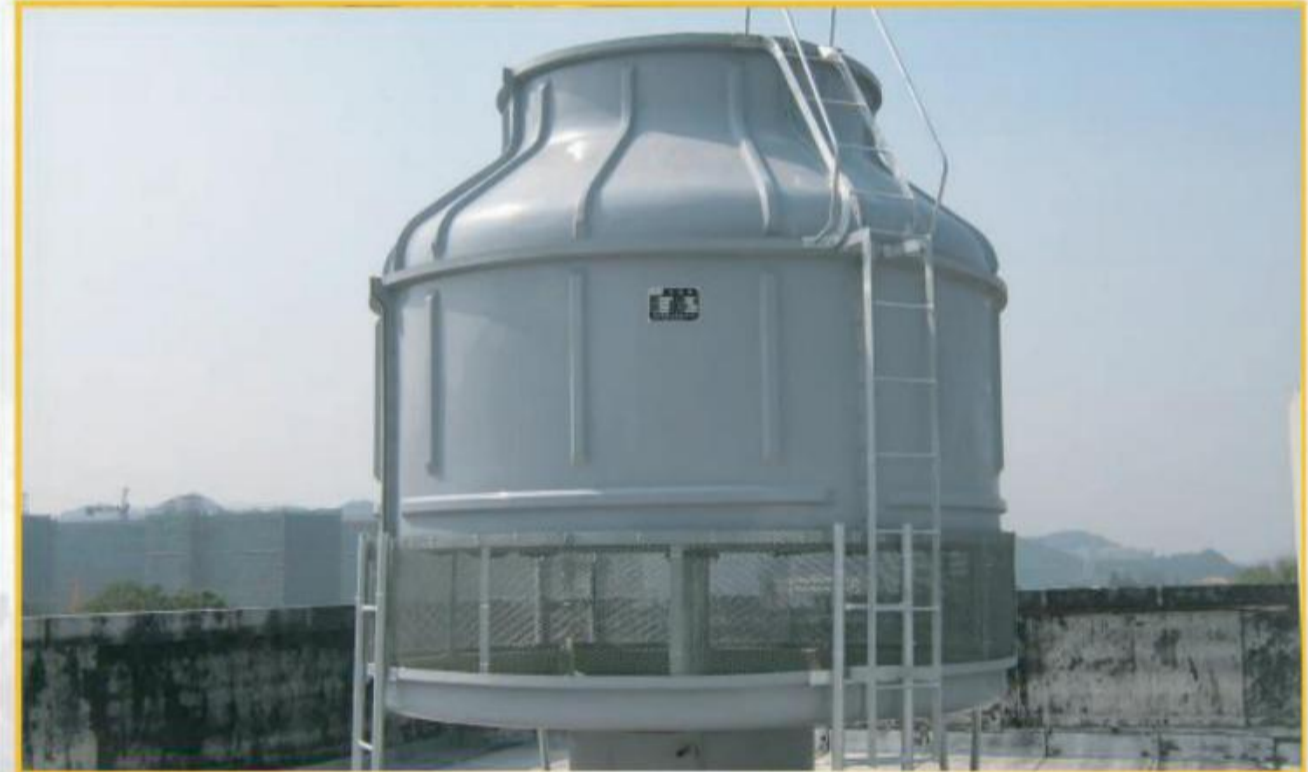
● برج مياه التبريد
